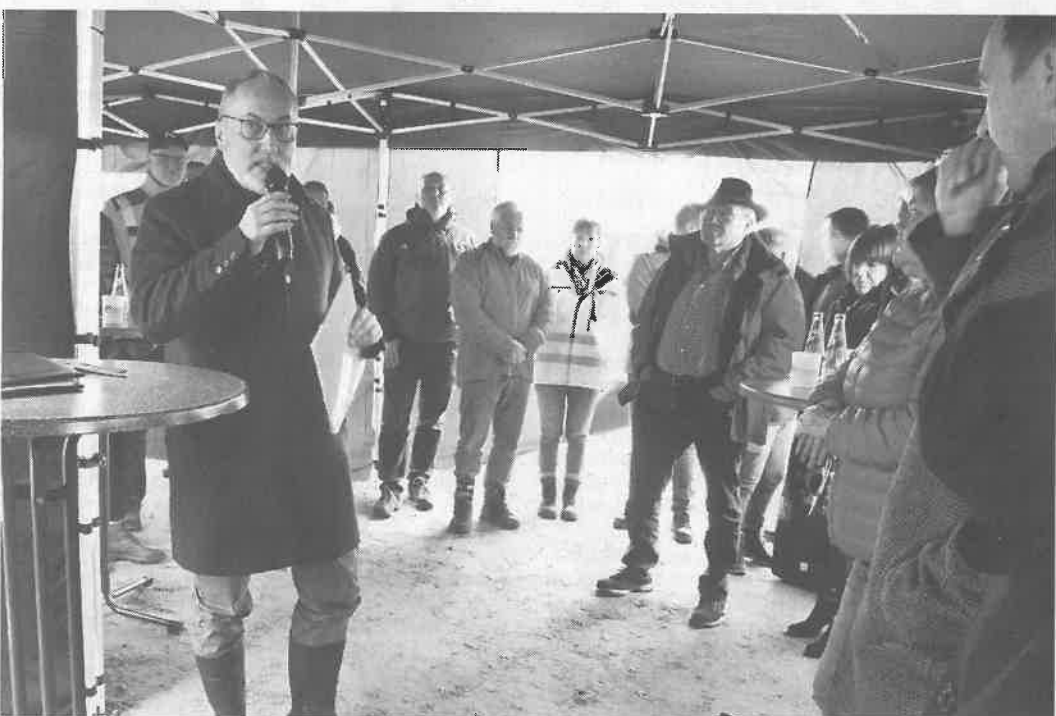
Bürgermeister Joachim Ruppert freute sich über viele Gäste beim Spatenstich für die neue TWA.
